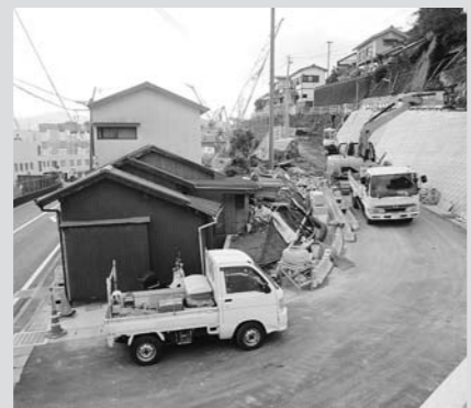
市道岩瀬道町東立神町1号線(L=198m、W=4m)は、現在50mの工事が進んでいるが今回110m延長される。完成予定は、平成24年10月頃の予定。(写真は岩瀬道町側)
